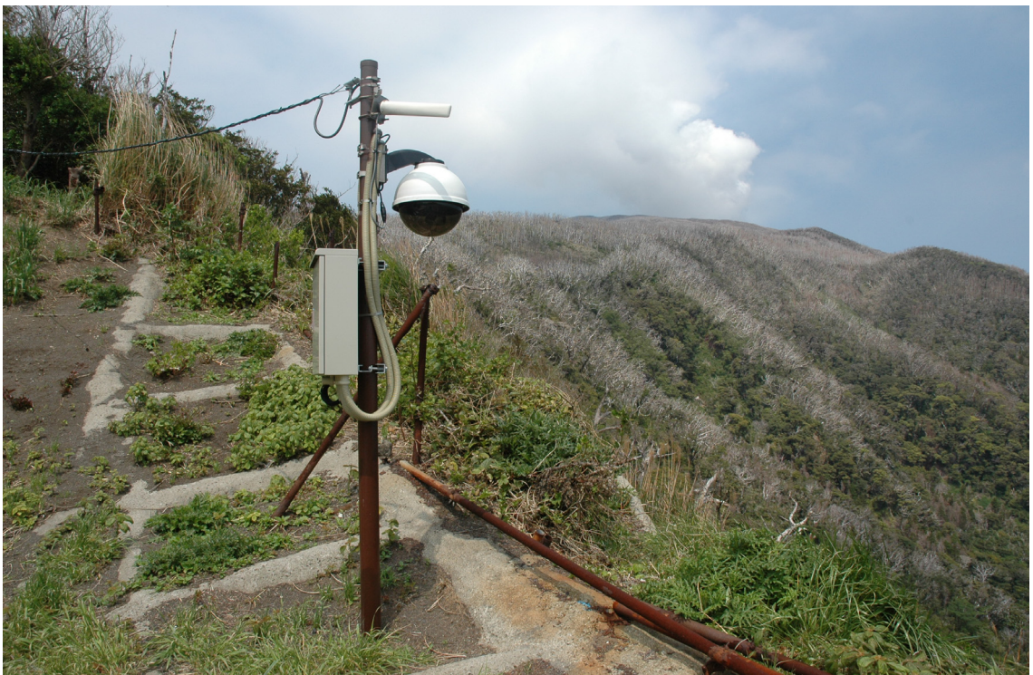
写真6. 遠景が見える位置に設置したインターネットカメラ
