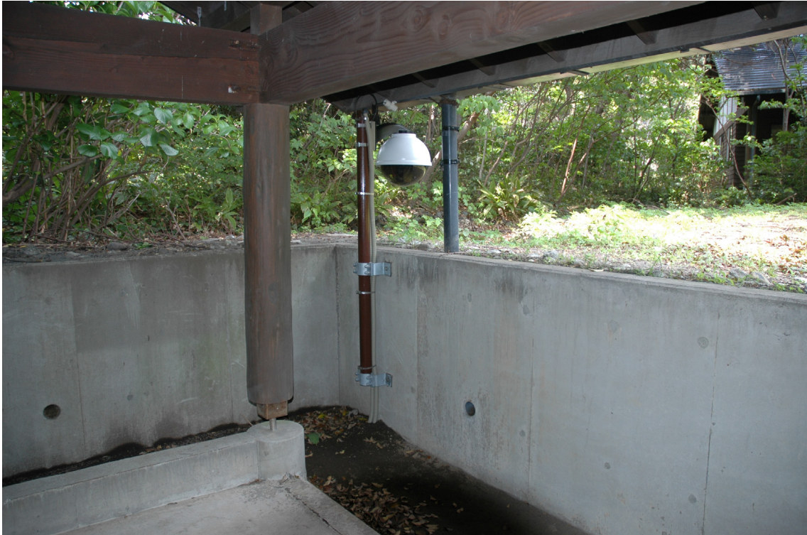
写真3. 本館に設置したインターネットカメラ
